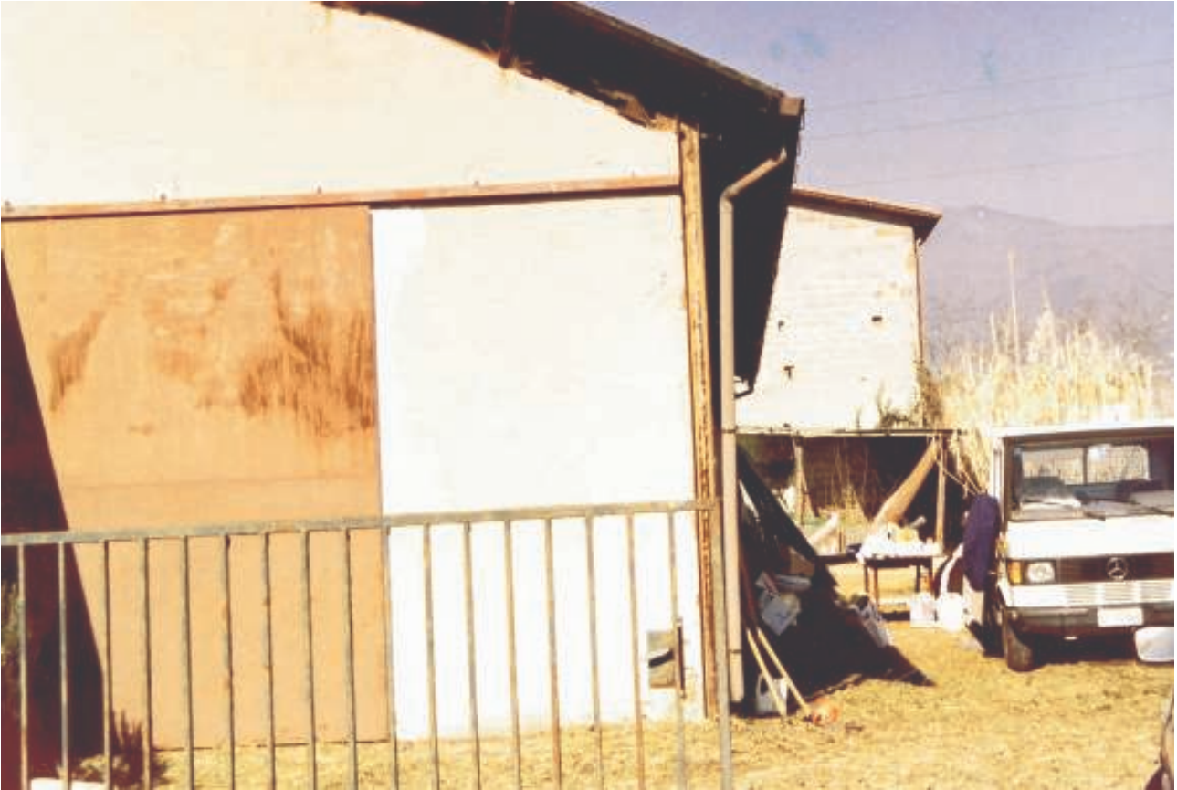
Presenza di tetto in Eternite
