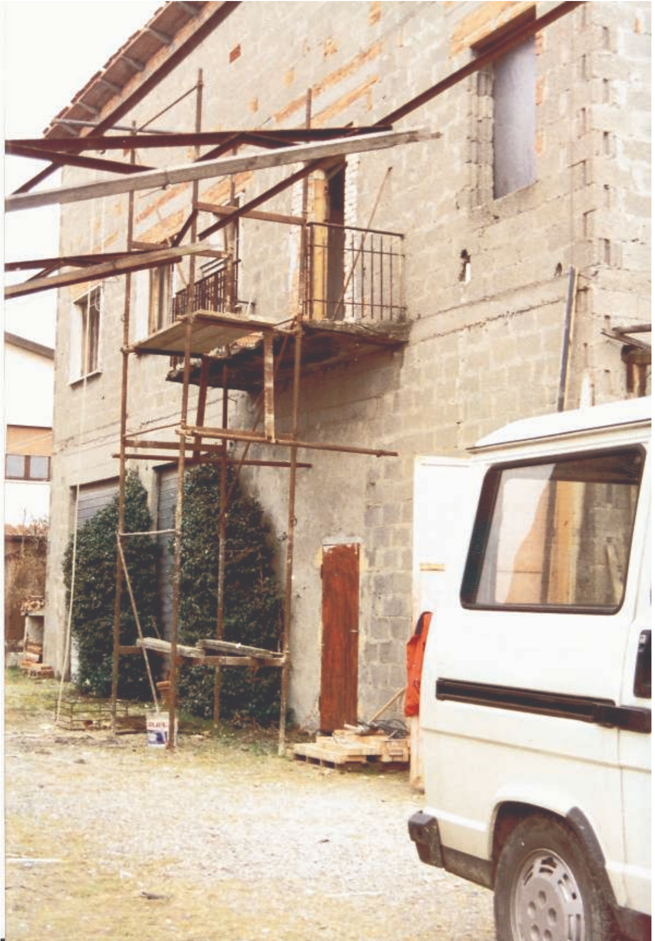
Lavori al Devadatta di Lucca – qualche anno fa Il Ponteggio non è certo a norma
